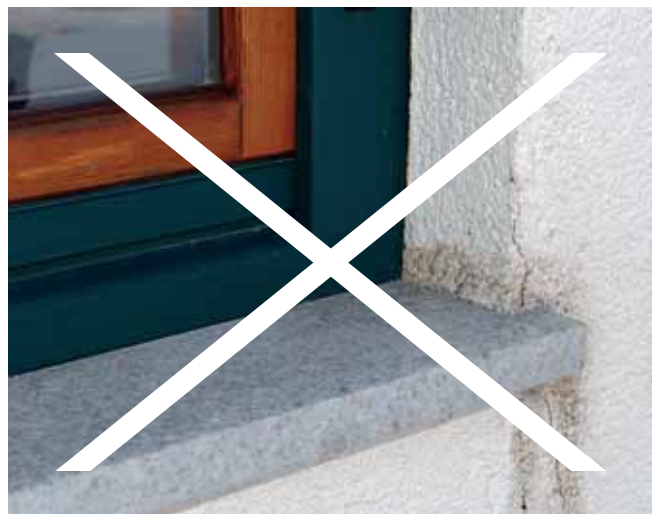
Falsch montierte Fensterbank
